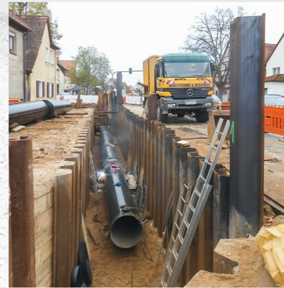
Trinkwasserleitung DN 900 in Rückersdorf
