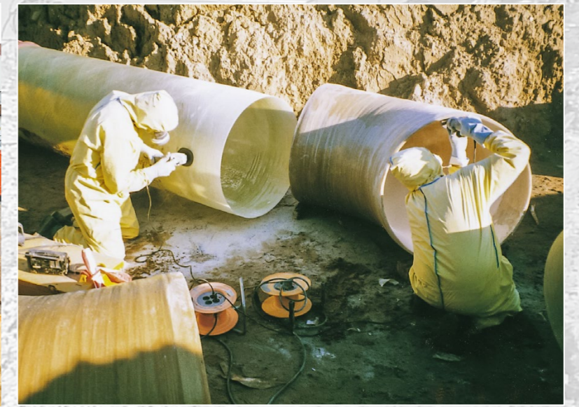
Rohwasserleitung GFK-Rohre DN 800
