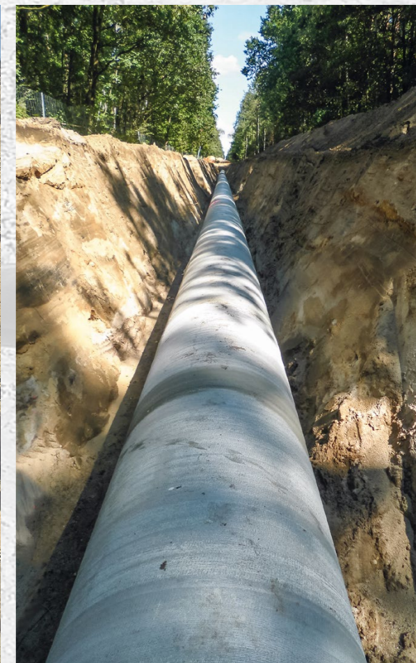
Haupttransportleitung Trinkwasserversorgung Burgkennitz
