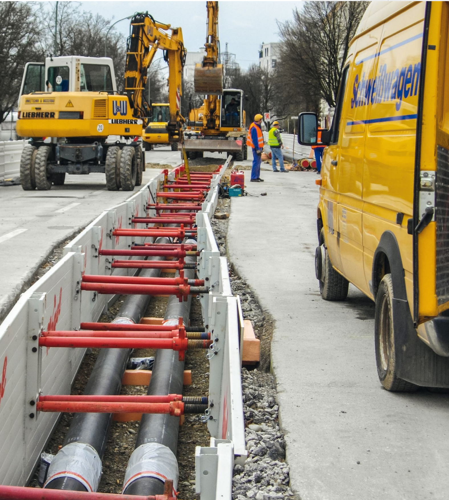
Fernwärmeleitung Stadtwerke München KMR DN 250
