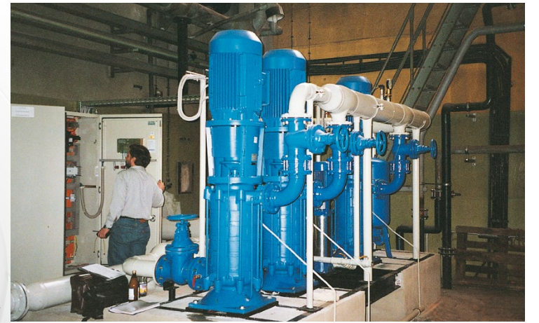
Feuerlöschpumpstation Kraftwerk Lippendorf
